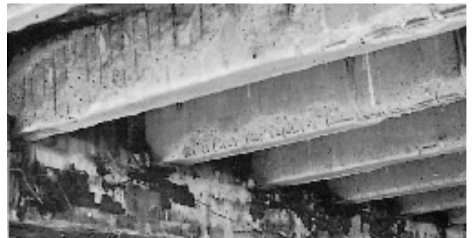
Bild 5 a: Zustand des Bauteils nach dem Brand
