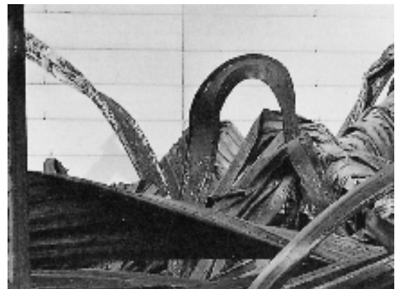
Foto 3: Zustand der Brandwand zur Maschinenfabrik am nachfolgenden Tage; die verformte Stahlkonstruktion lässt auf die hohe Brandbeanspruchung schließen.
